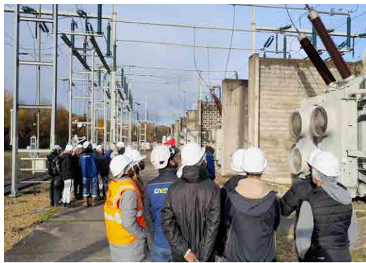
Poste de transformation électrique ENEDIS
