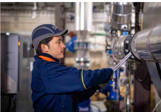
Chaufferie biomasse DALKIA
