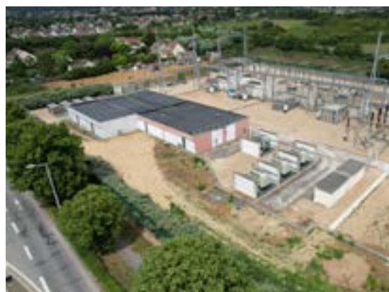
Poste source Enedis
